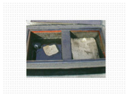
油水分離槽の浮遊油処理
